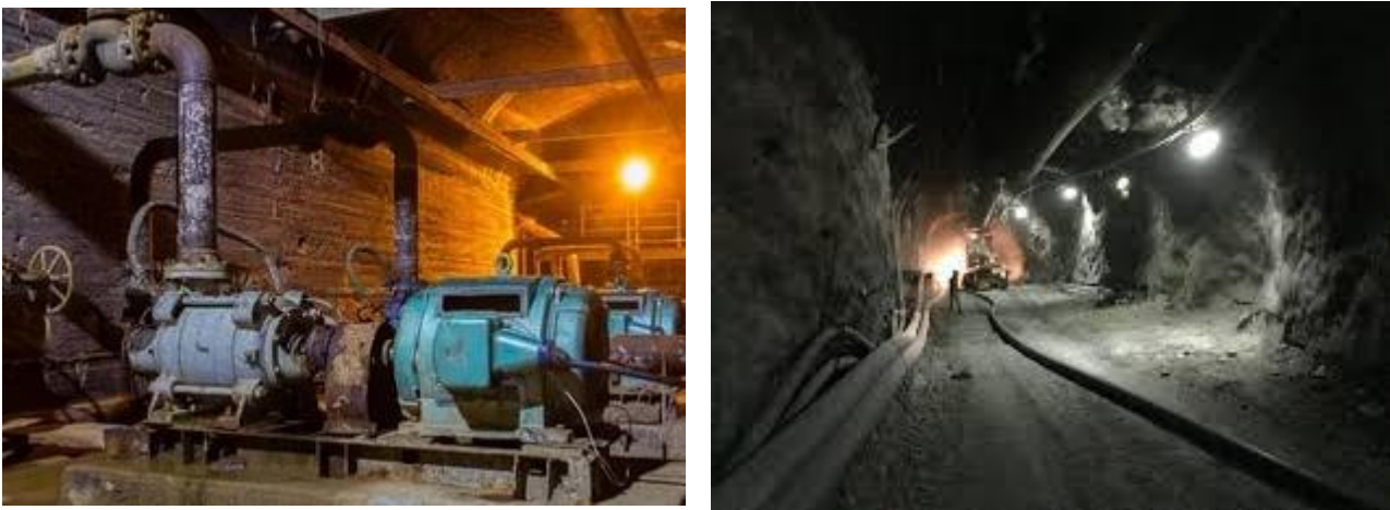
Рис. 1.1.2 Камера головної водовідливної установки шахти та транспортування шахтної води по шахтним вироботкам
